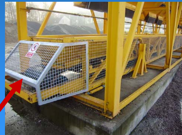
Prawidłowe osłony przenośnika taśmowego
